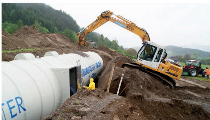
150.000 L Speicher mit mittiger Schieberkammer
