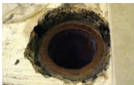
Bündig abgeschnittene Rohre.
