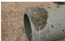
Teilweise oder komplett einbetonierte Rohre.
